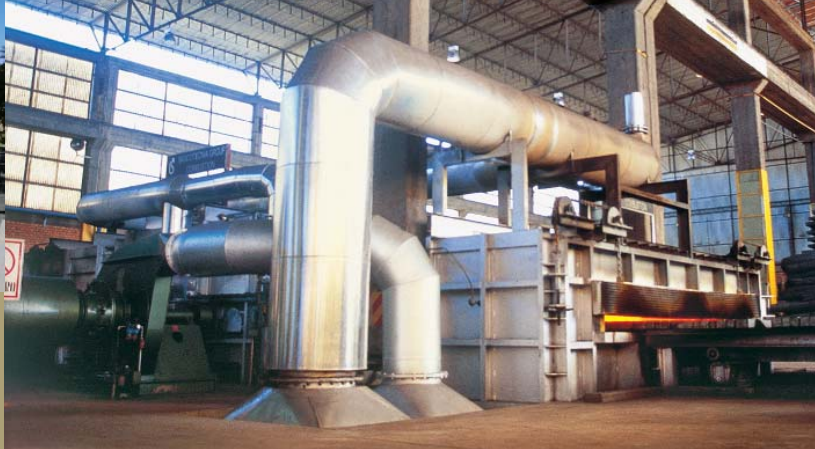
Horno Bascotecnia. Planta N°1 - Arequipa
